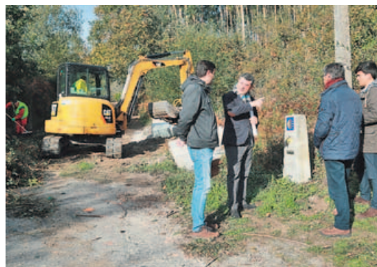
Ovidio Rodeiro visitó las obras del Camino a su paso por Vilvestro.
